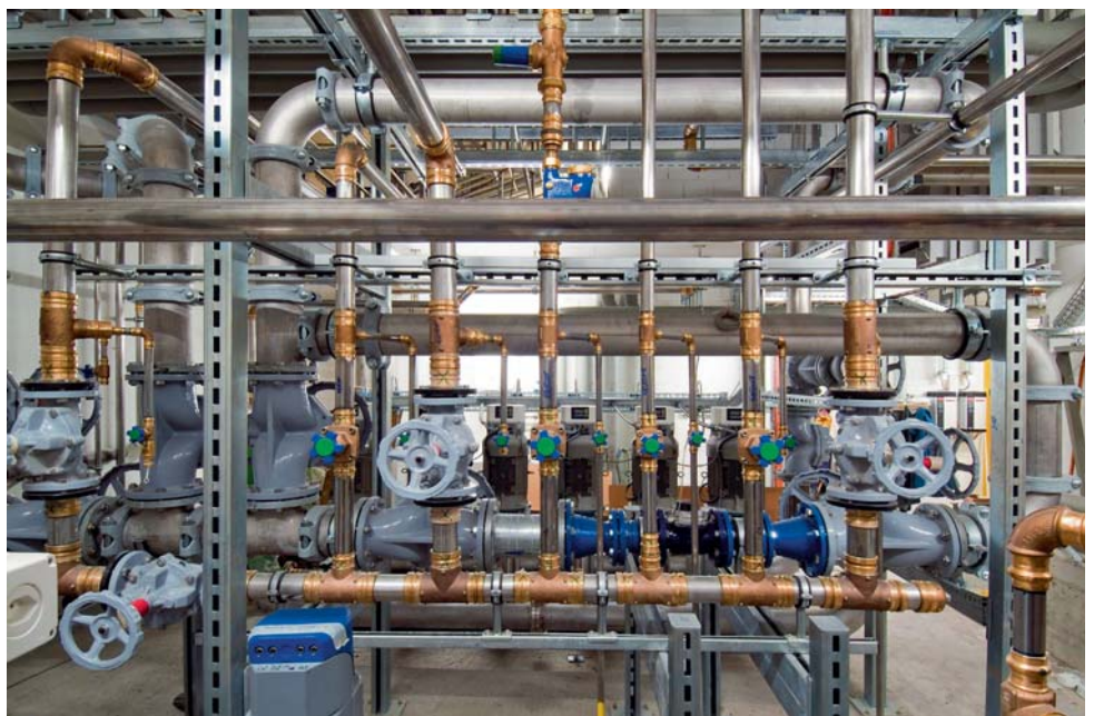
Abb. 10 Beispiel einer komplexen Installation: Hauptzentrale Wasserverteilung im Stade de Suisse Wankdorf Bern.
