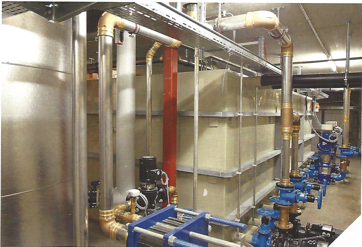
Das Optipress-Edelstahl-Systemrohr 1.4521 von Nussbaum im Einsatz in einem Industriebetrieb.
